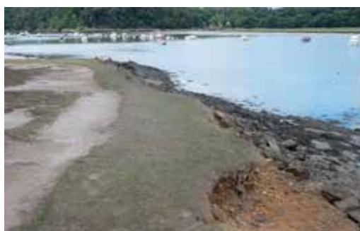
Terre-plein ostréicole parti à la mer par manque d'entretien.
