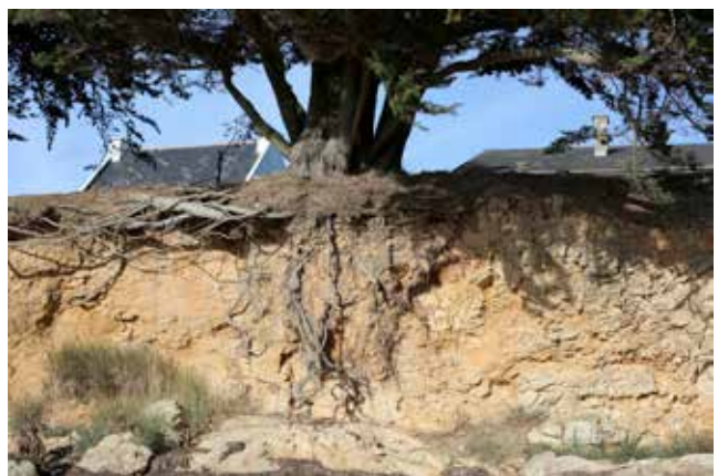
Erosion du substrat lié au ruissellement des eaux de pluie conjugué à l'effet de la mer, provoquant la déstabilisation de l'arbre et à terme sa chute.
