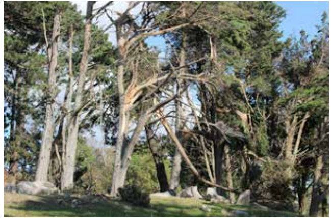
Ruptures de branches massives après le passage d'une tempête présentant un réel danger pour les personnes.
