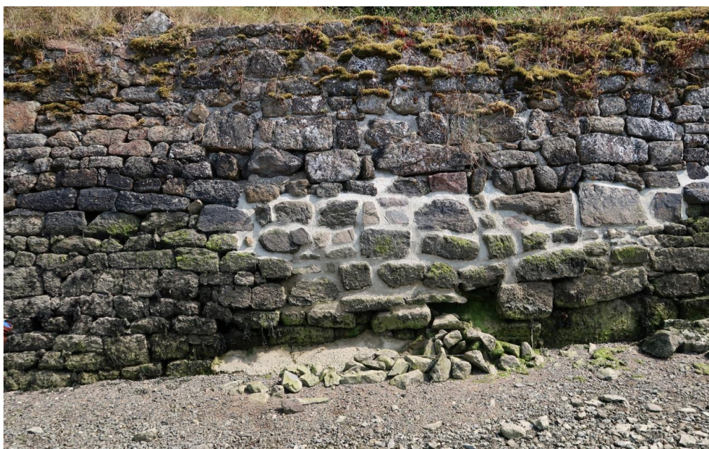
Figure 31 : Mur de pierre sèche déstabilisé par une rénovation au ciment, Pleudihen-sur-Rance (22). Crédit : Région Bretagne (2020)
