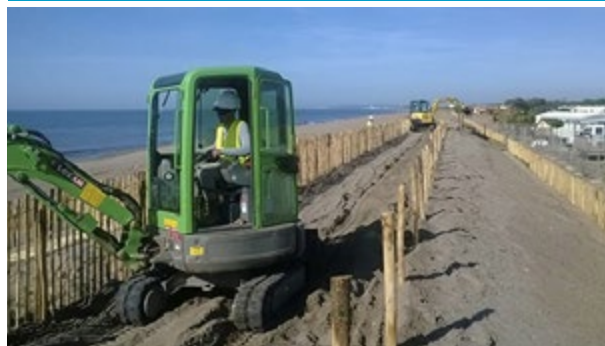
Littoral de Vias (Hérault) : reconstitution du cordon dunaire. Faute d'un dispositif complémentaire de brise-houle immergé au large, ces aménagements seront malheureusement détruits par les tempêtes de l'hiver suivant Photo © Communauté d'agglomération Hérault-Méditerranée
